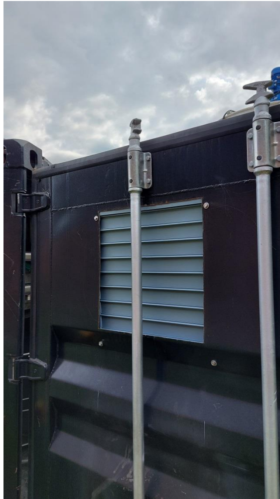
Abb. 7 Zuluftjalousien an der Containerstirnseite
