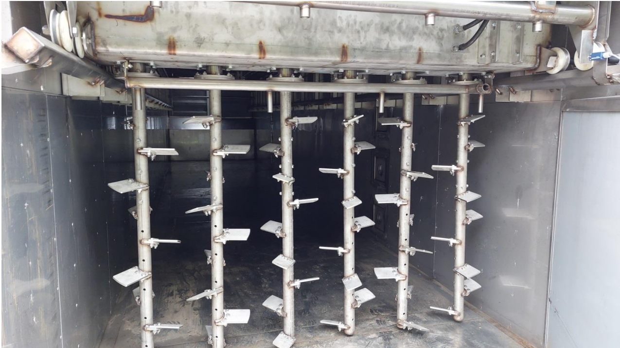
Abb. 8: Mischwerk der DükonaR-Anlage
