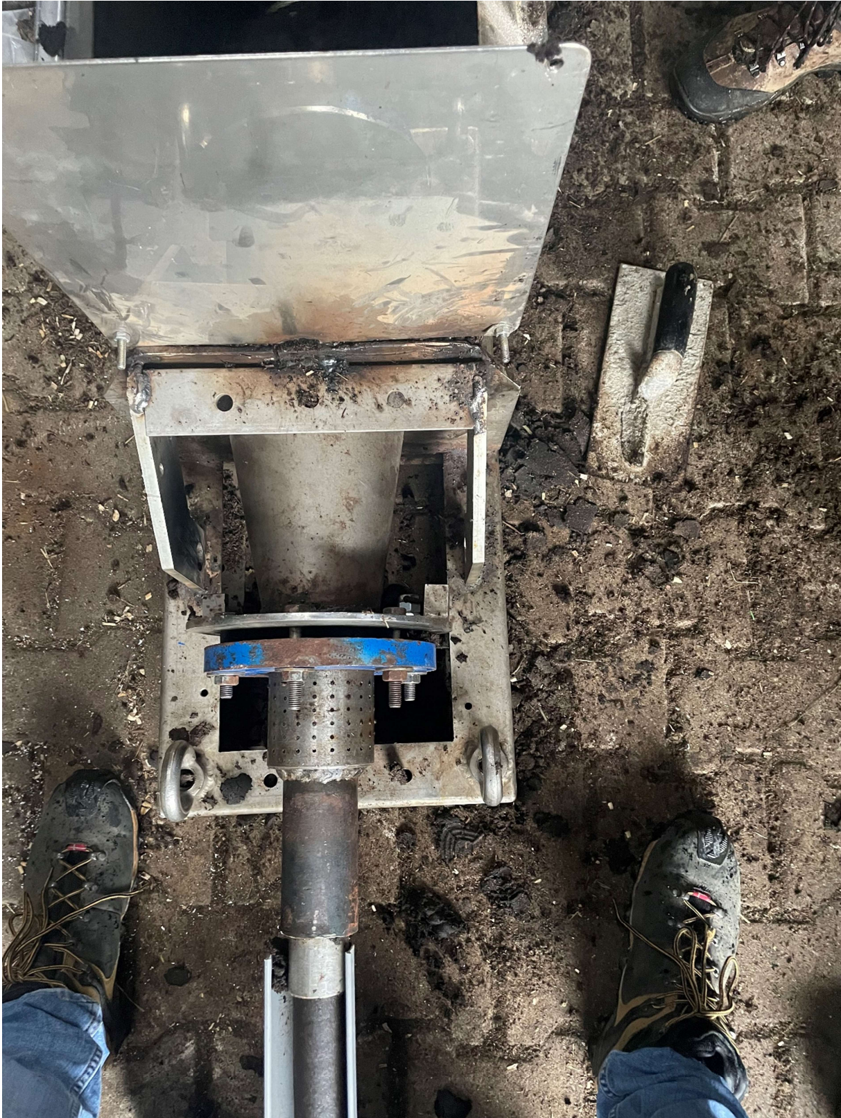
Presse nach Umbau. Rohre kleinerer Durchmesser, kleine Schnecke geht trichterförmig in größere Schnecke über
